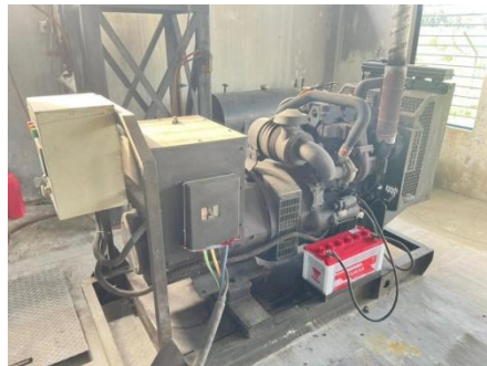
Gambar 2. 1 Gambar Genset 50 KVA
