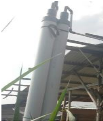
Gambar. 3 Tabung pemurnian biogas
